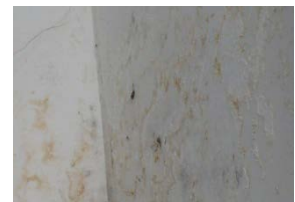
Durchfeuchtungen im Wandbereich
