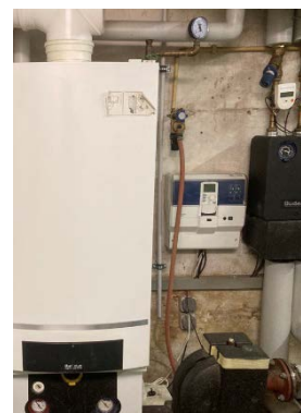
Zentraler Heizkessel vor Gebäudemodernisierung
