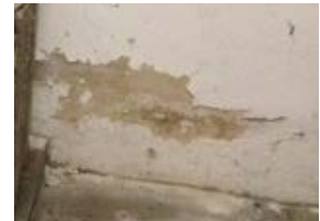
Farb- und Putzabplatzungen
