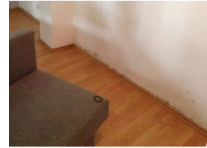
Feuchteverfleckungen im Sockelbereich
