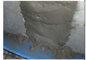
Mörtelreste hinter Randdämmstreifen
