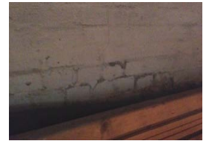
Feuchteflecken an der Kellerwand
