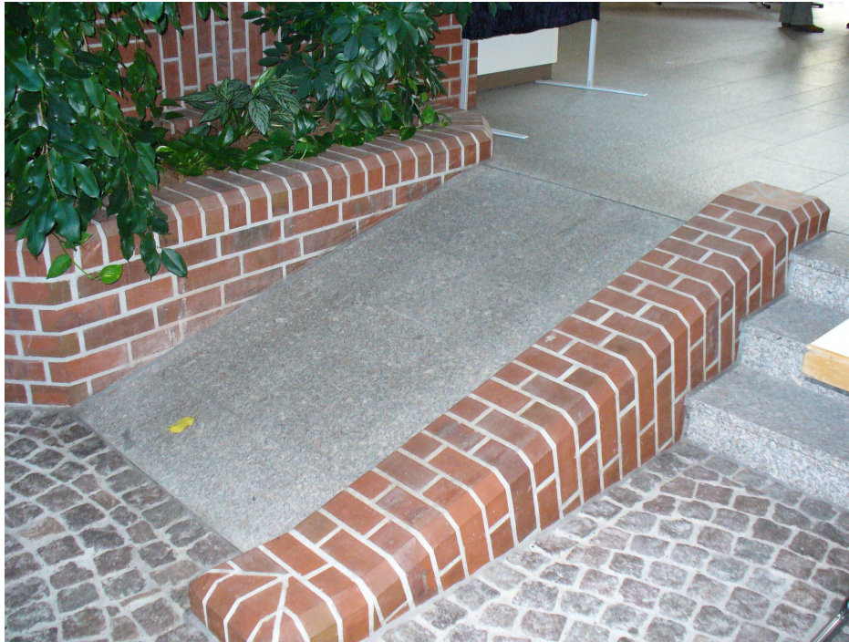
Abb. 2. Beispiel einer nicht normgerecht ausgeführten Rampe
