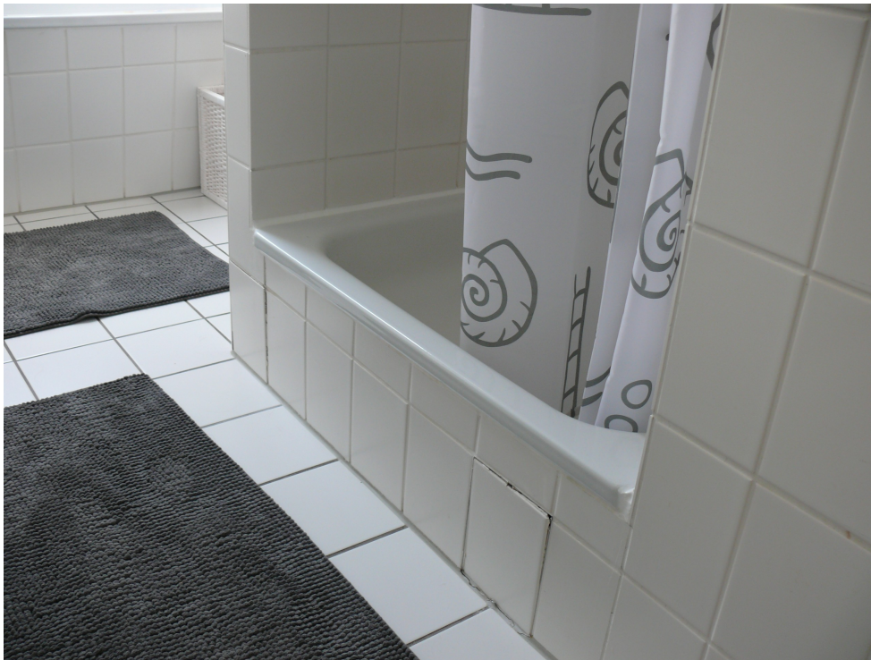
Abb. 3: Beispiel einer nicht barrierefrei nutzbaren Duschwanne
