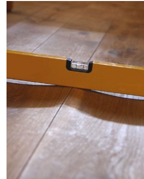
Verformungen („Schüsselungen“) von Holzdielen
