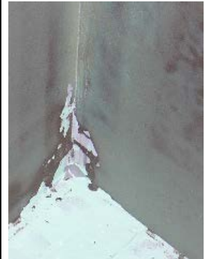
Lückenhafte Verbundabdichtung in einem Bad
