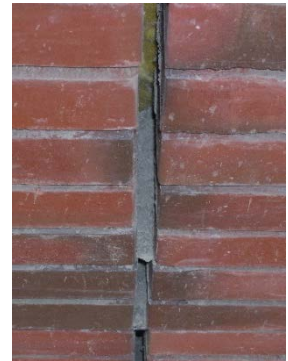
Mörtelreste in der Schalltrennfuge
