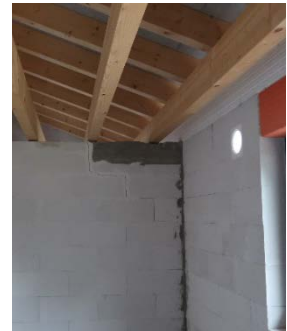
Risse im Mauerwerk aufgrund fehlender Ringbalken bzw. Ringanker
