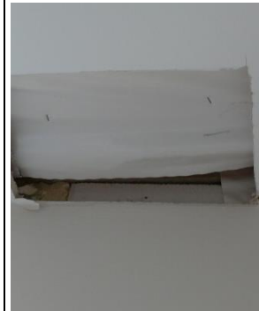
Nicht fachgerechter Anschluss einer luftdichten Ebene
