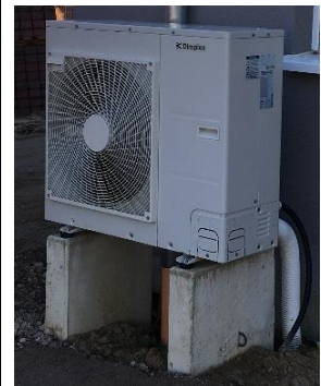
Außenmodul der Luft-Wasser-Wärmepumpe
