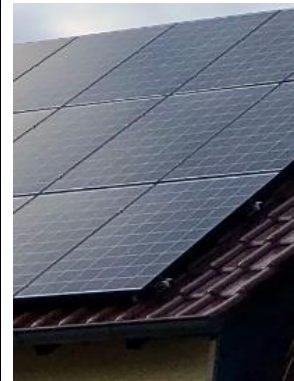
PV-Anlage auf Steildach nach Mangelbeseitigung
