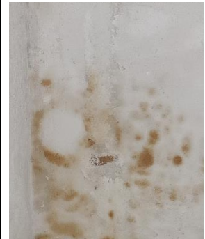
Verfärbungen / Verfleckungen auf der Wand aufgrund eines versotteten Kaminzugs
