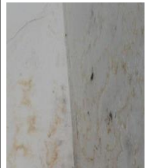
Durchfeuchtungen und Feuchteverfleckungen im Wandbereich eines Kellerraums
